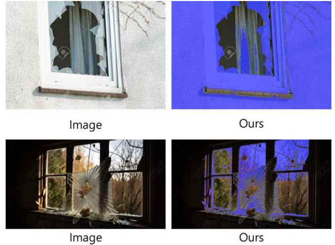
그림 4 파손 상태 유리창 입력을 사용한 검색 결과물 예시.
